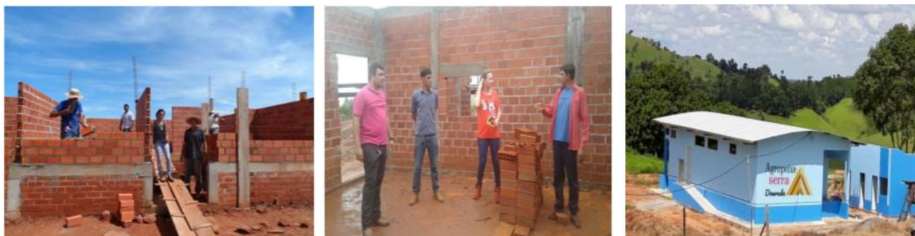
Figura 49, 50 e 51. Início da Construção da Agroindústria, 2018 Supervisão Regional da EMATER/2019, Conclusão da Agroindústria,2020. Fonte: Esloc Novo Horizonte.
